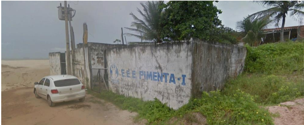
Foto 12 – EEE Pimenta 1- Estação Elevatória de Esgoto. Totalmente inoperante. Na desembocadura do Rio. Foto tirada em 2019.
