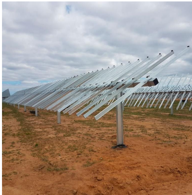
Figura 2. Estruturas para painéis fotovoltaicos
