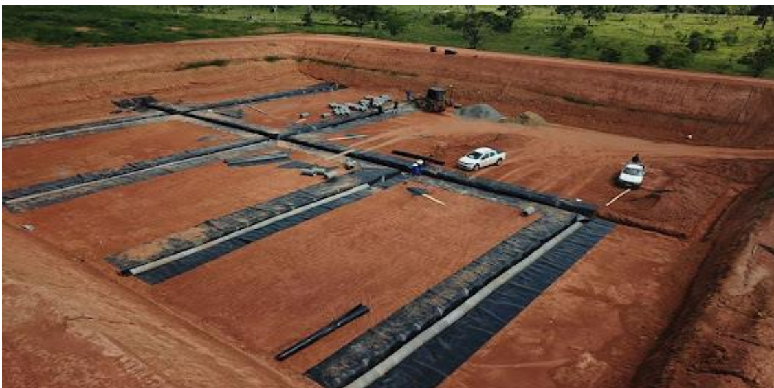
Imagem 6: imagem da instalação de dreno de chorume e de uma caixa de deposição do mesmo (Fonte: http://jaru.ro.gov.br/ )
