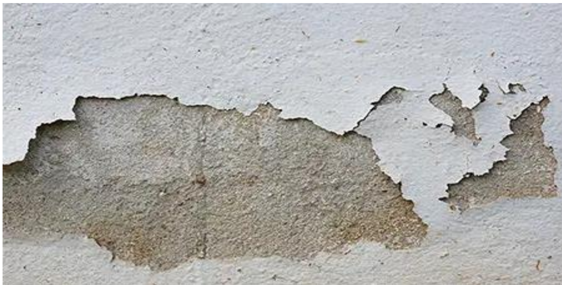
Figura 5 – Pintura descolando devido à umidade Fonte: viva decora
