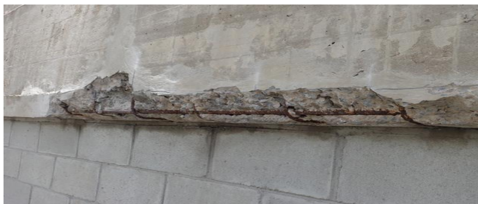
Figura 3 – estrutura com armadura aparente devido à umidade
