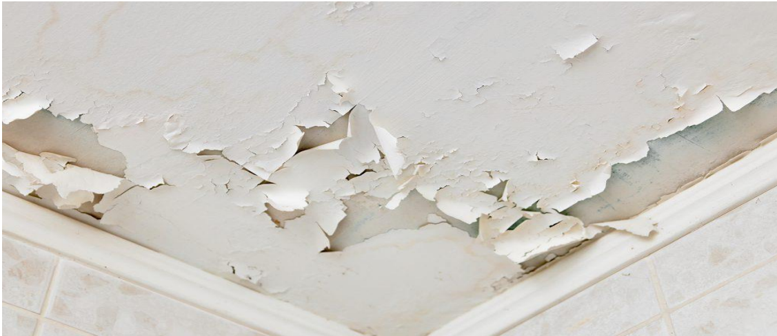
Figura 4 – descascamento na laje devido à umidade Fonte: hydronorth
