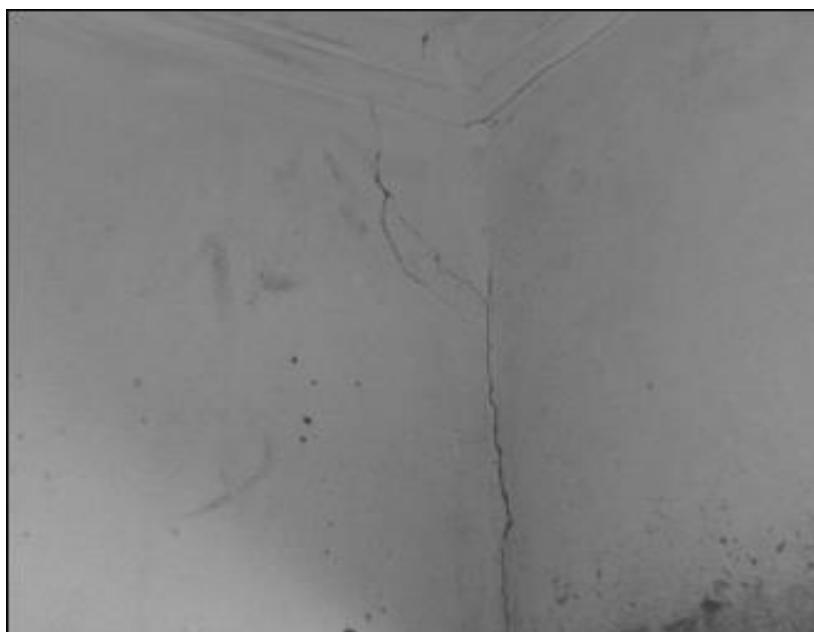
Figura 3 – Fissuras na parede e forro. Foto: Ronnielle Cabral, 31/02/2009.
