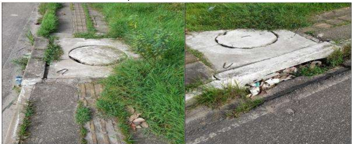
FIGURA 7 – BOCAS DE LOBO OBSTRUÍDAS
