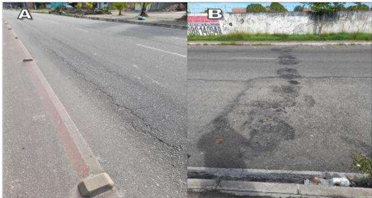
FIGURA 5 - (A) TRINCA LONGITUDINAL LONGA; (B) DEGRADAÇÃO SUPERFICIAL
