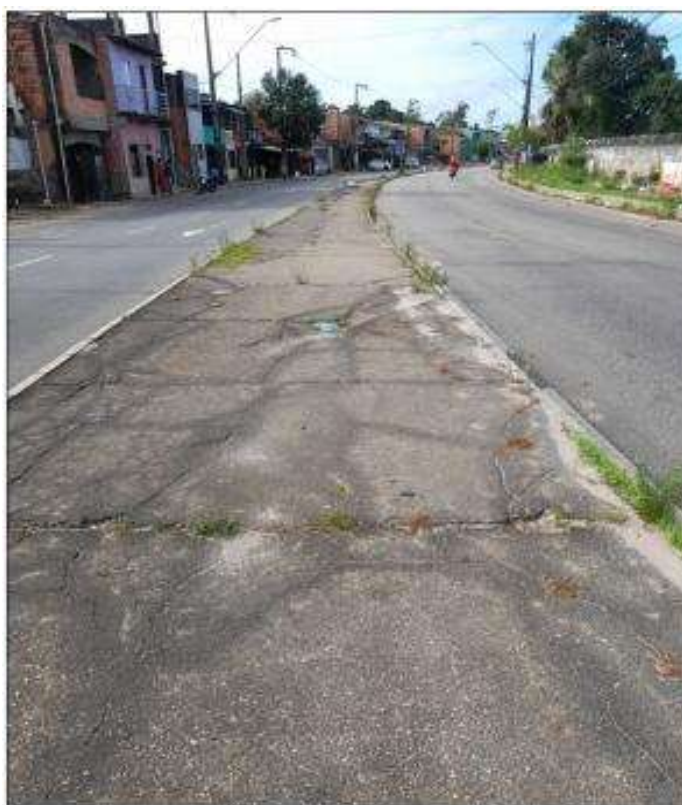
FIGURA 9 - TRINCAS NO CALÇAMENTO DO CANTEIRO CENTRAL
