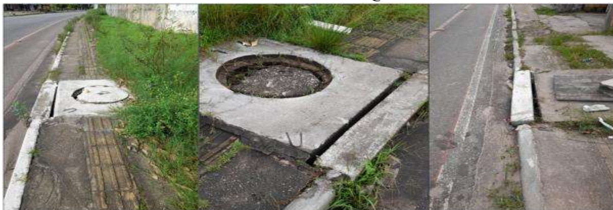
FIGURA 8 - BOCAS DE LOBO COM TAMPA QUEBRADA OU AUSENTE
