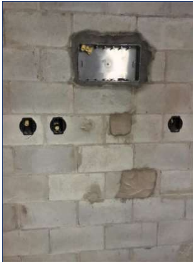
Figura 27 – Alvenaria quebrada devido a não passagem de conduítes
