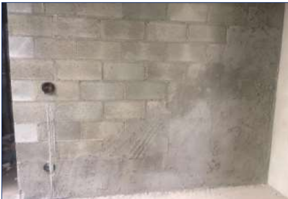
Figura 26 – Parede com reboco por alvenaria fora de régua
