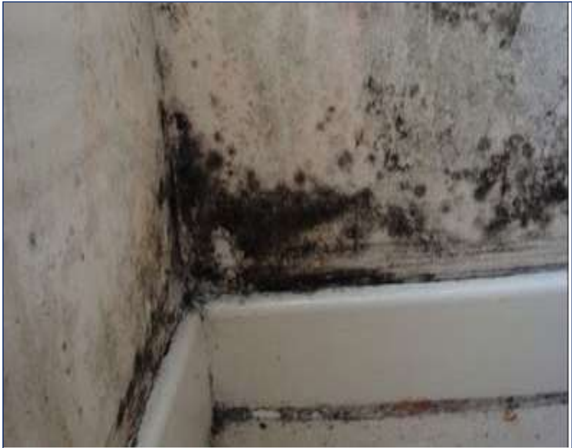
Figura 28 – Infiltração e Umidade
