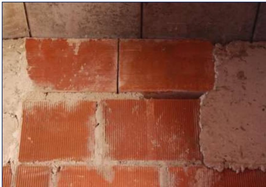
Figura 20 – Alvenaria com juntas horizontais sem preenchimento
