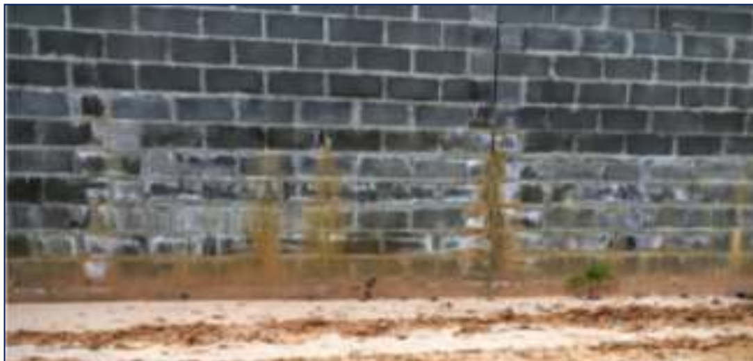
Figura 29 – Eflorescências em Blocos de Concreto em Alvenaria Estrutural
