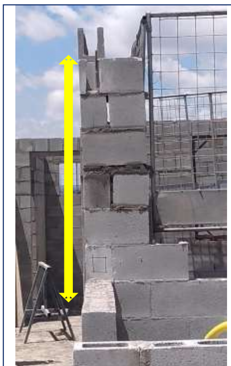
Figura 25 – Parede Fora de Prumo
