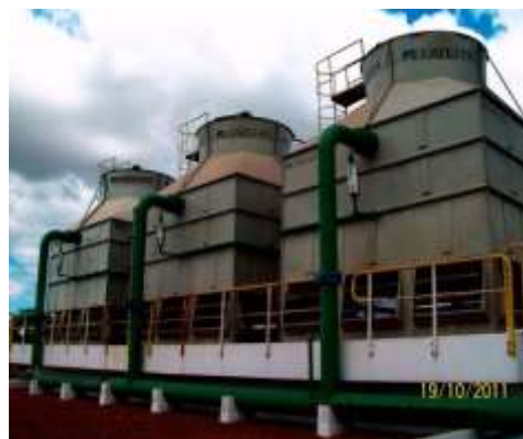
Figura 4 - Torres de resfriamento usadas atualmente
