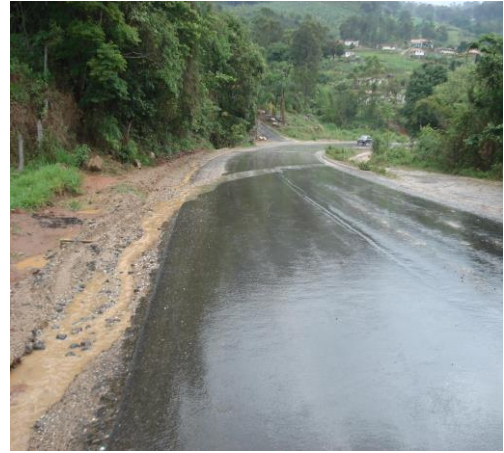
Imagem 6. Falta da Sarjeta
