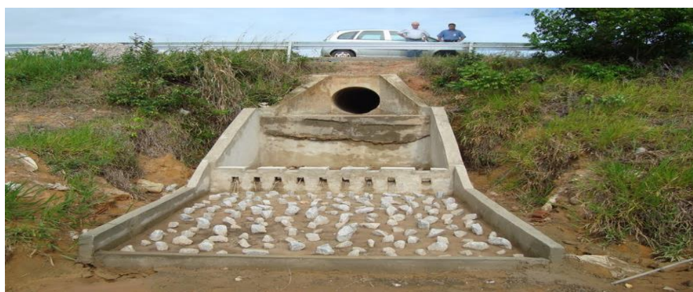
Imagem 17. Dissipador de energia em saída de bueiro como forma de contenção de processos erosivos
