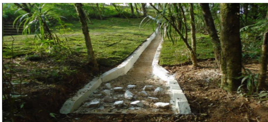
Imagem 16. Dissipador de energia
