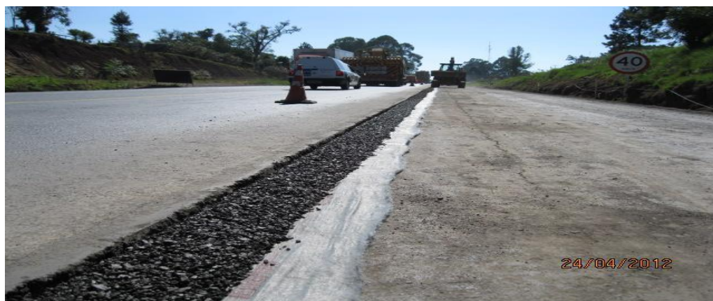
Imagem 26. Dreno raso longitudinal
