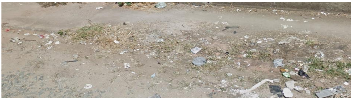
Figura 7: Meio fio em processo de degradação
