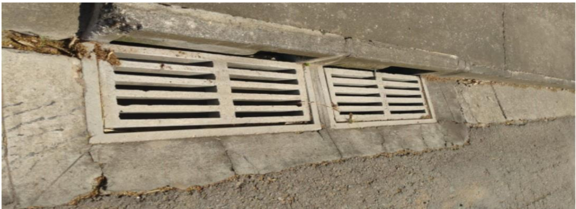
Figura 10: Boca de lobo do tipo combinada
