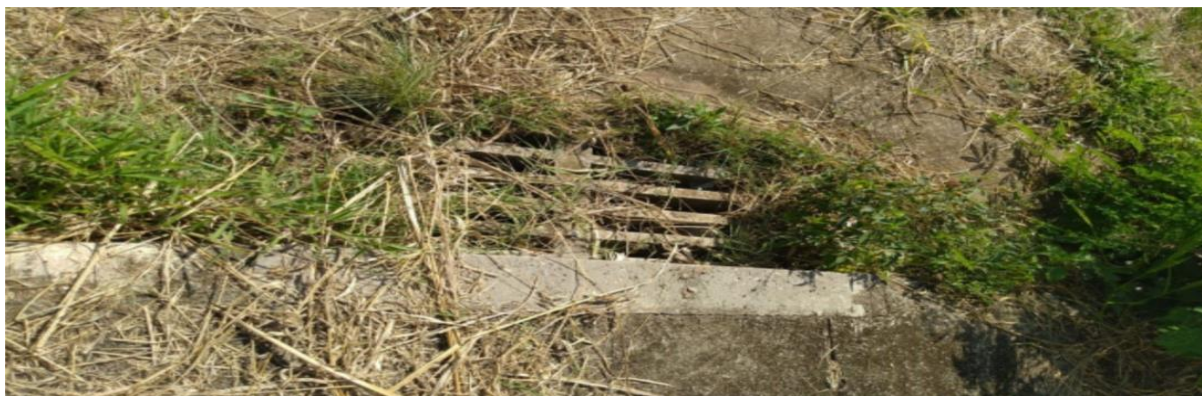
Figura 12: Boca de lobo obstruída por excesso de vegetação
