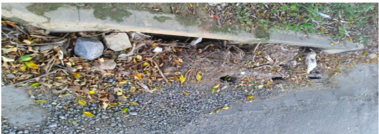
Figura 11: Boca de lobo com obstruída por lixo
