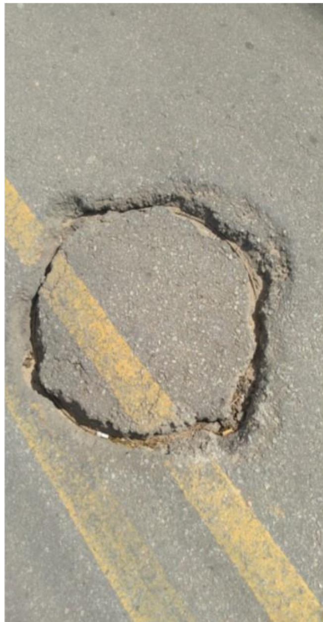
Figura 14: Situação de alguns tampões dos poços de visitas PVs.
