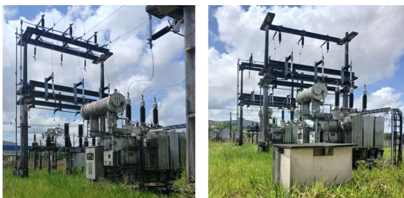
Figura 3 - Vista da subestação de 69 kV da UFAL com destaque para os transformadores de força de 5/6,25 MVA.
