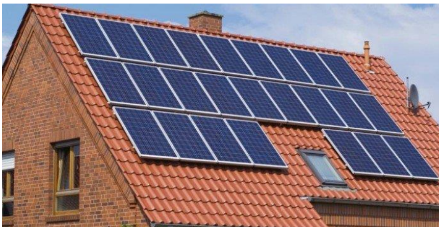
Figura 4 – Telhado com placas fotovoltaicas
