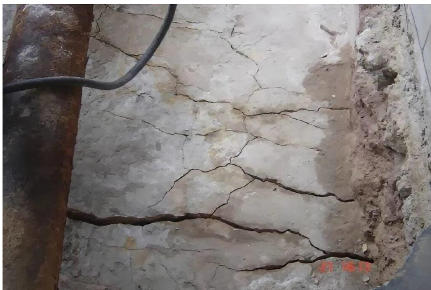
Figura 2 - Estrutura comprometida por reação álcali-agregado
