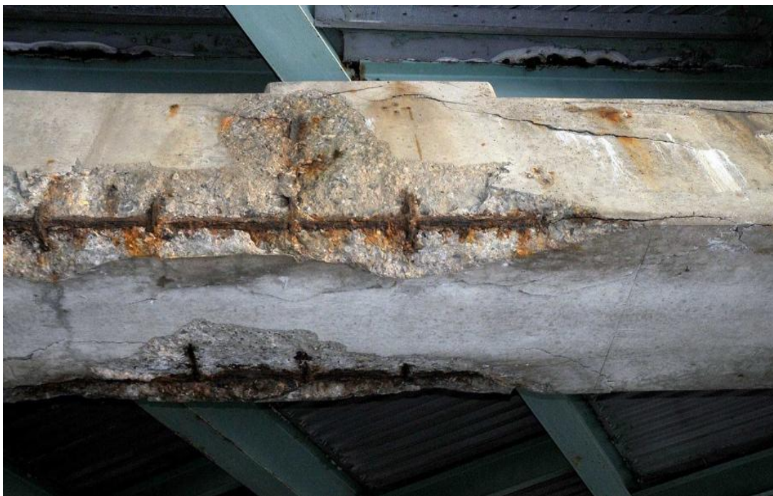
Figura 4 - Estrutura de concreto com ataque de íon cloreto
