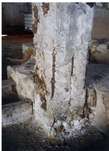
Figura 3 - Pilar degradado pela ação de íons de sulfato
