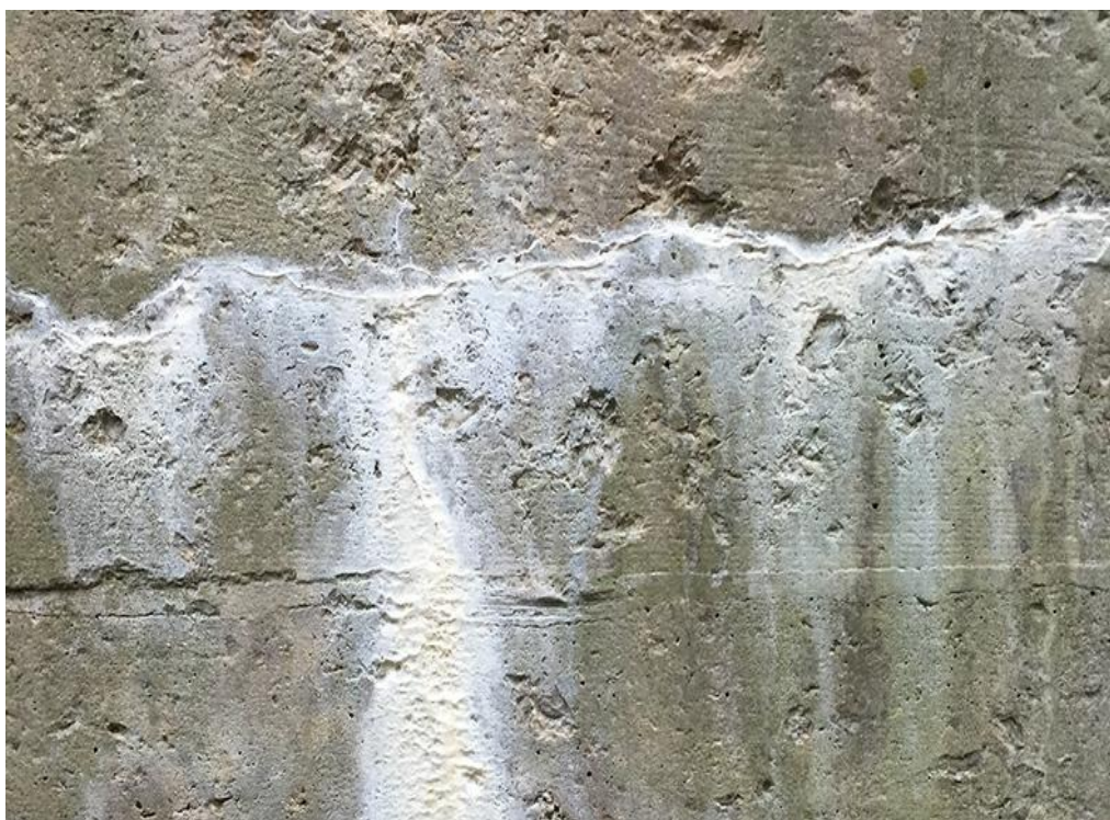
Figura 1 - Lixiviação no Concreto armado
