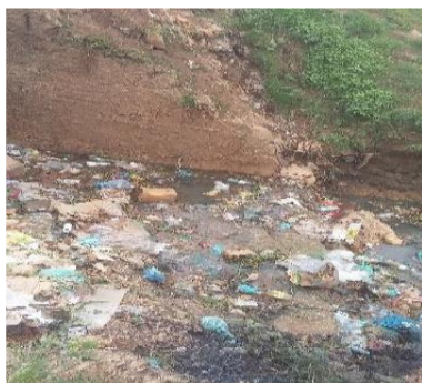
Figura 3: canal de drenagem ou vala completamente obstruído por sacos plásticos e lixo doméstico.
