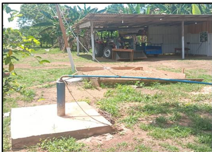
Figura 3 – Poço artesiano da Associação ASCCLA
