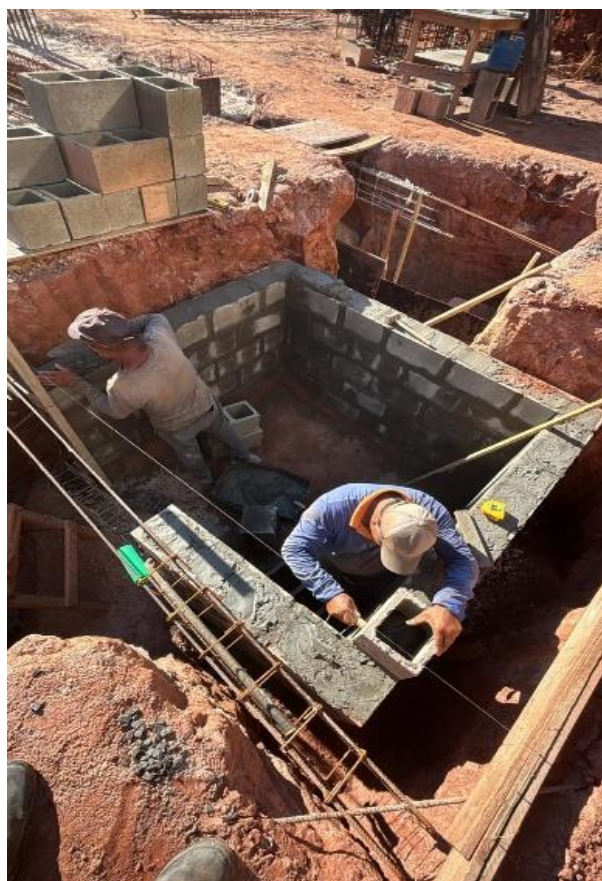
Figura 4 – Trabalhadores executando atividades em canteiro de obras com uso inadequado de Equipamentos de Proteção Individual (EPIs), evidenciando falhas no atendimento às normas de segurança do trabalho.
