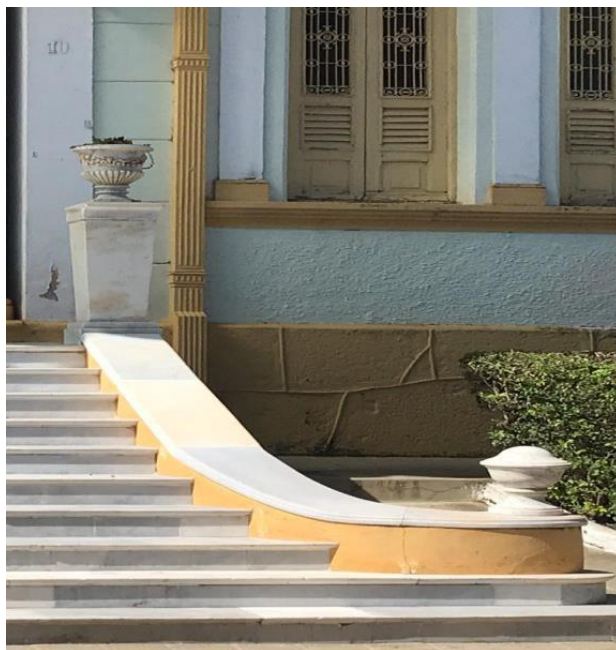
Figura 10 – Fissuras e perda de camada de acabamento em região de maior exposição ambiental.
