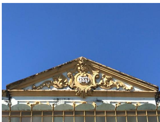
Figura 9 – Detalhe de crostas negras em elementos ornamentais do frontão principal.
