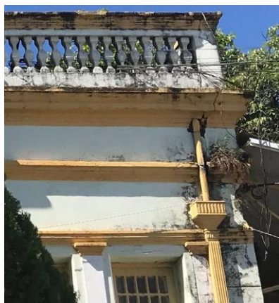
Figura 8 – Visualização de vegetação de pequeno porte e destacamento de argamassa
