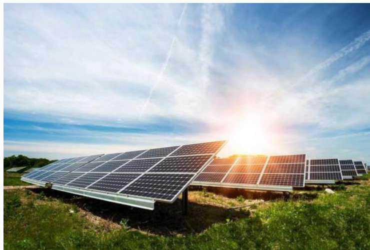
Figura 4: Placas de painéis fotovoltaicos (Brasil Escola, 2018).
