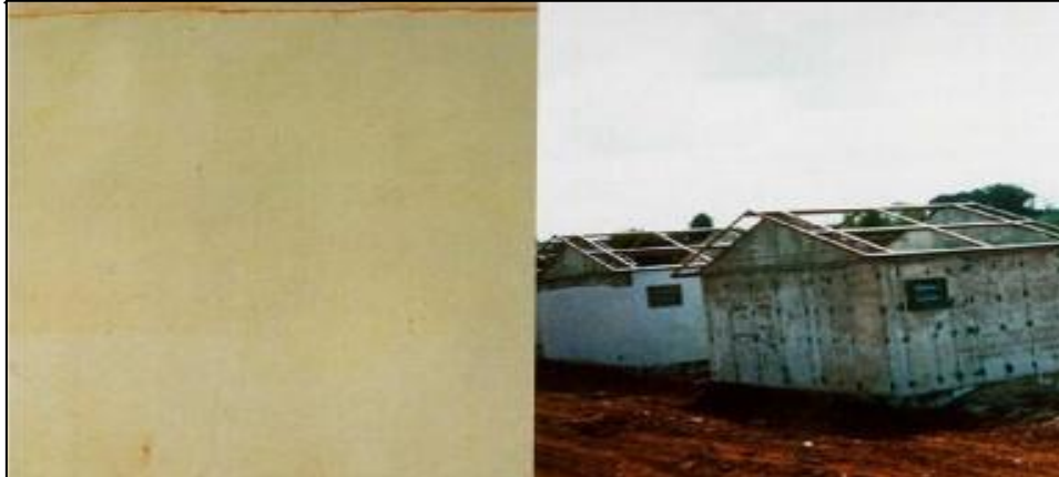
Figura 1 – Fissura horizontal na parede por deficiência na estanqueidade entre as formas.
