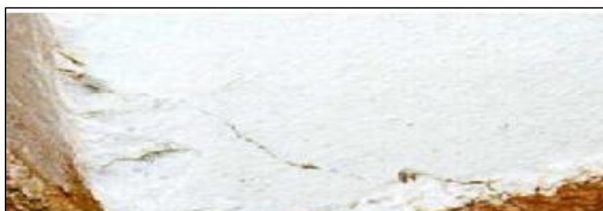
Figura 7 – Fissura inclinada em função do recalque de fundação
