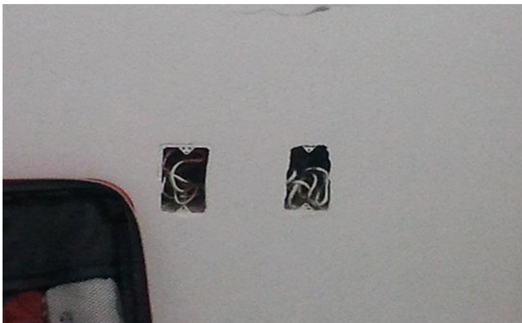
Foto 5: Falta de Acabamento Elétrico Fonte: Do Próprio Autor, 2018.
