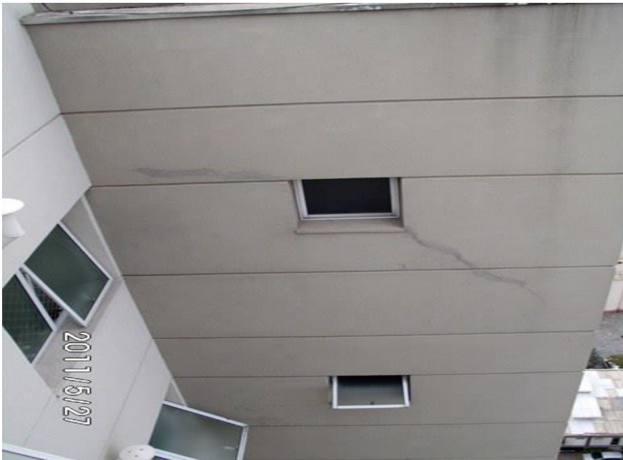
Foto 9: Trincas na Fachada Fonte: Site IBAPE Nacional, 2011.
