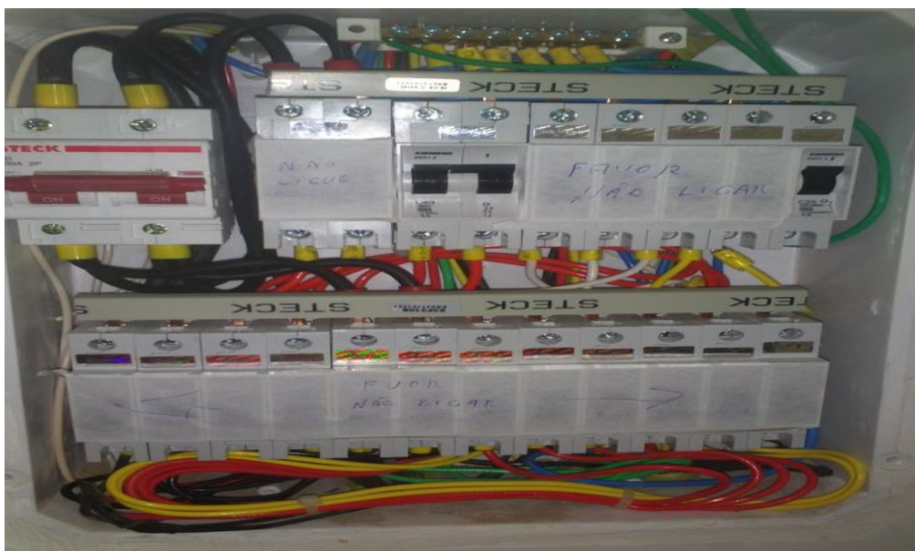
Foto 4: Falta de Identificação dos Circuitos Fonte: Site Habitíssimo, 2009.
