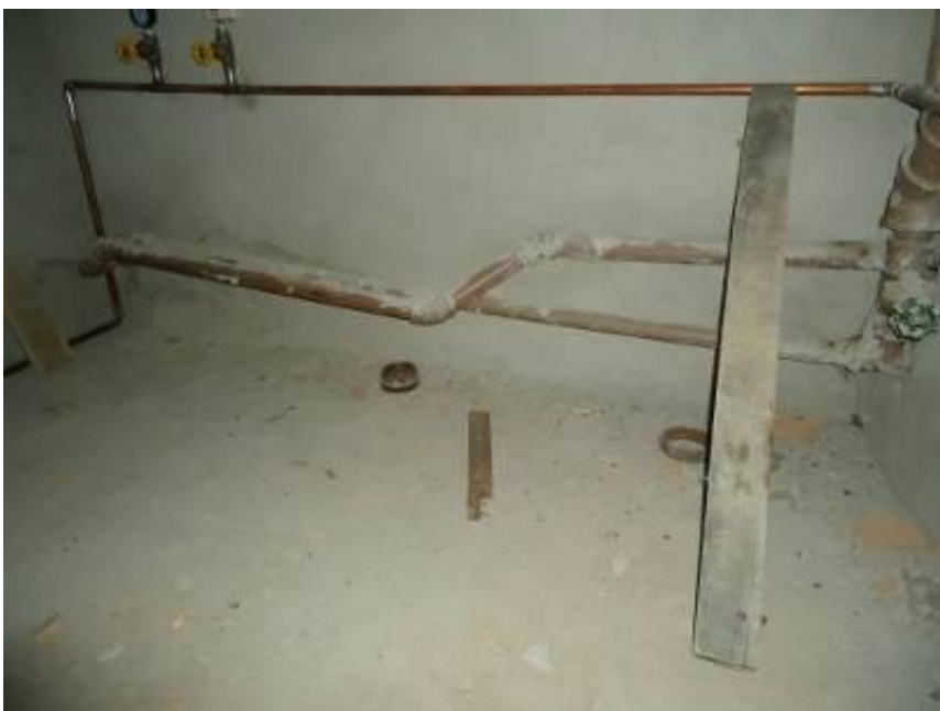
Foto 7: Improvisado na Fixação das Tubulações Hidráulicas do Barrilete Fonte: Site IBAPE Nacional, 2011.
