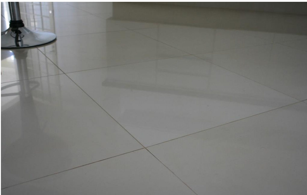
Foto 3: Desconformidade na tonalidade do piso
