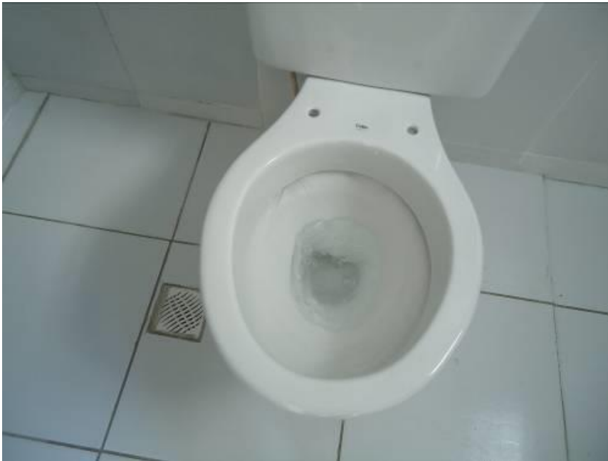
Foto 8: Problemas na Descarga Fonte: Site IBAPE Nacional, 2011.
