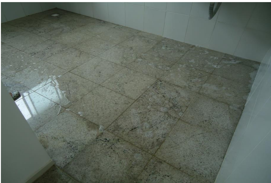
Foto 10: Vazamentos e Caída da Água em Sentido Inverso ao Ralo Fonte: Site IBAPE Nacional, 2011.
