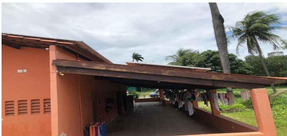
Figura 7 – Desafios de manutenção da infraestrutura
