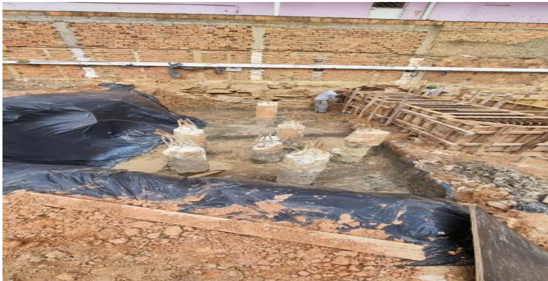
Figura 1- Confeção de elementos de fundação com utilização das formas convencionais de madeira.
