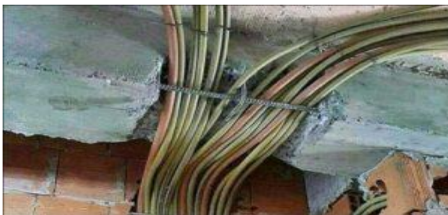
Figura 4 – Falha de execução
