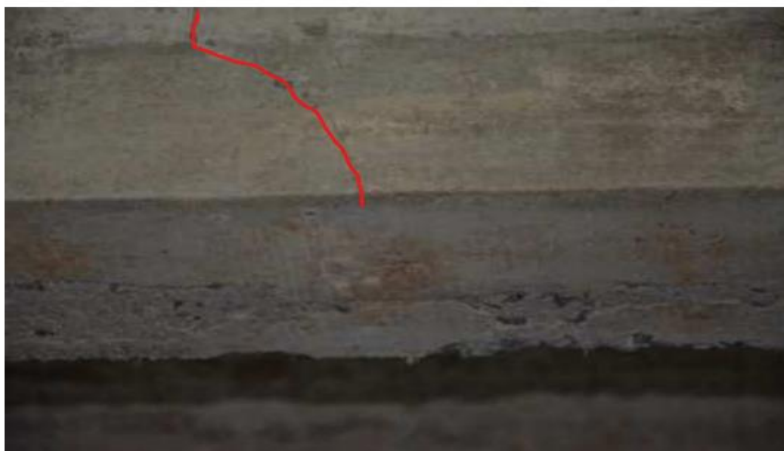
Figura 2 – Trinca vertical em viga
