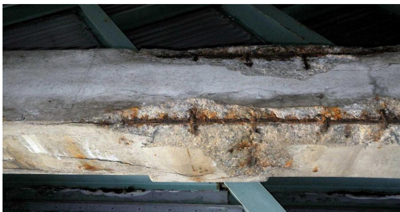
Figura 3 – Corrosão nas armaduras
