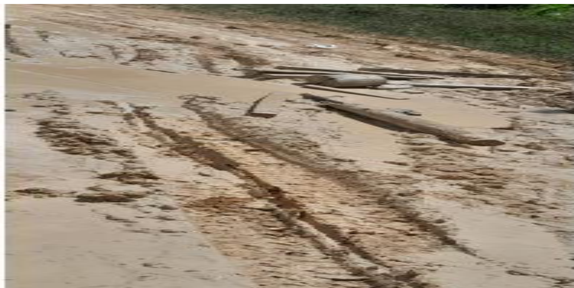
Figura 5. Ponto de alagamento do ramal, KM 174. Imagem: Lima (2023).
